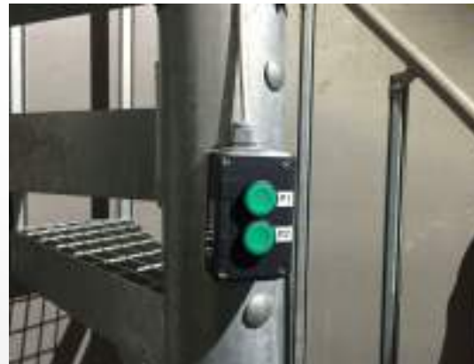
Tablå med knapper for lokalkjøring av pumper
