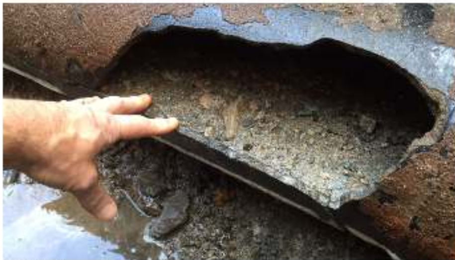
MÅNDAL: Gamle vannrør i stopejern fra 1887. © DRIKKEVANNSTILBUD / NTB
