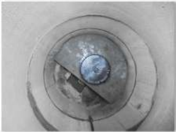
Tett lokk SP-ledning
