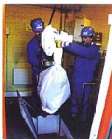
Pumpen som skal til service legges i engangssekken (nedbrytbar).
