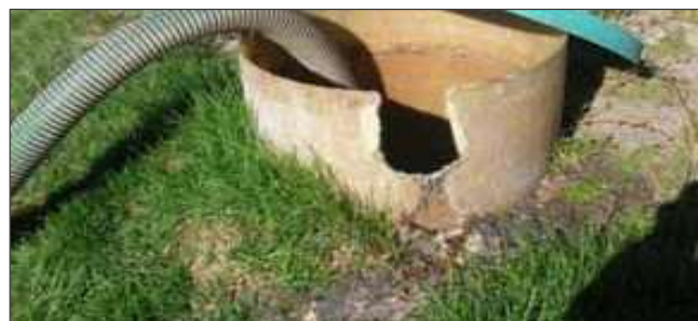
Øverst: Utslipp til bekk uten årssikker vannføring. Utslipet fører til forurensning og smittefare. Nederst: Tett tank som mangler alarm for full tank. (Foto: Tilsynet for små avløpsanlegg i Drammensregionen)
